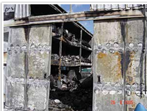
Dégâts occasionnés par une réaction exothermique entre déchets incompatibles © DREAL Auvergne-Rhône-Alpes
