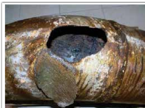
Domages liés à la corrosion sur une tuyauterie © DREAL Pays de la Loire
